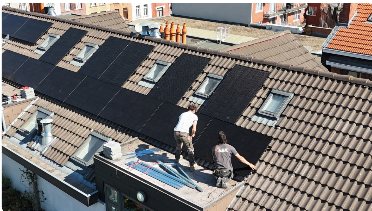
Installation solaire sur la copropriété Vanderkindere à Molenbeek en avril 2026
