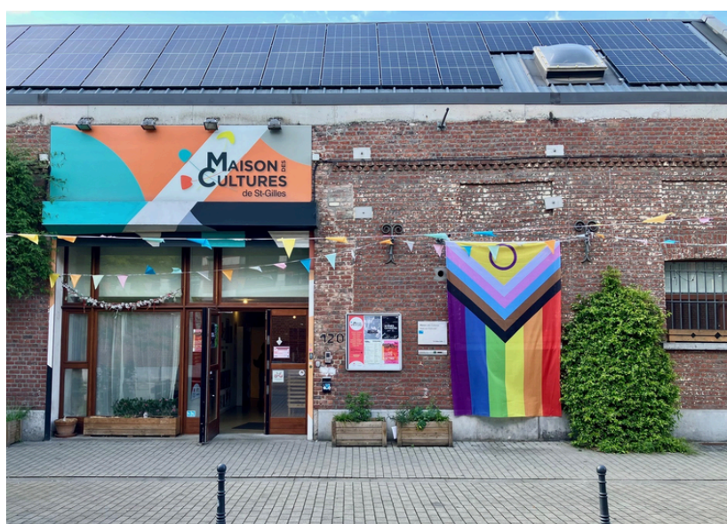
Fotovoltaïsche installatie op de daken van het cultuurhuis in Sint-Gillis
